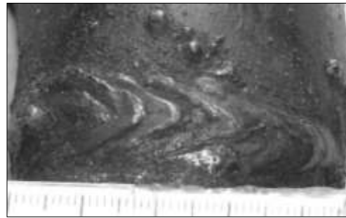
Рис. 1. Сварочный шов на трубе, выполненный ручной электродуговой сваркой, по факту обнаружения незаконной врезки в нефтепровод.
